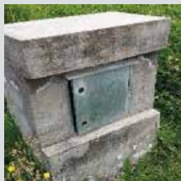
Cajas de control externas
